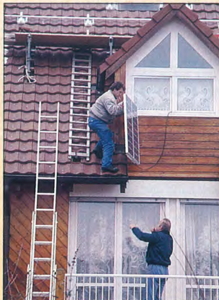
Hoch mit den Zellen! Die Pannels mussten einzeln auf das Dach gebracht werden, wo sie nachher auf die silbrig glänzenden Ziegel (oben im Bild) montiert wurden.
