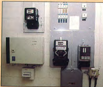
Herzstück der Photovoltaik-Anlage: Der Wechselrichter (grauer Kasten links unten) sorgt für die Umwandlung von Gleich- in Wechselstrom.
