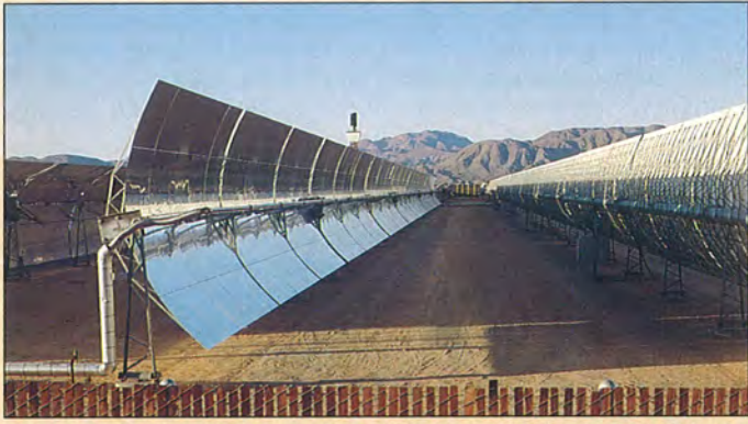
Sonnenenergienutzung in Grosskraftwerken: Die Hohlspiegel bündeln das Sonnenlicht und werfen es auf die mit einer Flüssigkeit gefüllten Rohre (in der Brennlinie).
