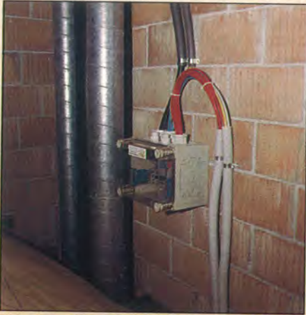
Verkabelung unter dem Dach: Die roten und blauen Kabel der Solarmodule (Pannels) laufen hier zusammen. Eine Hauptleitung führt in den Keller zum Wechselrichter. Das gelbe Kabel ist der Blitzschutz.
