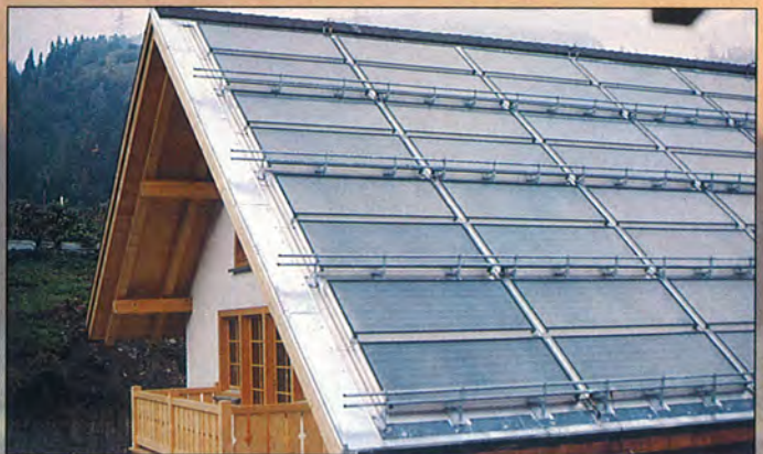
Warmwasserkollektoren als Dachkonstruktion: UCLIVA in Waltensburg GR
