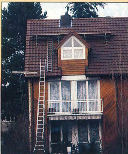
Alles war am 10. Dezember 1990 bereit: Anstelle der Installateure kam in der Nacht der grosse Schnee. Das Baugerüst blieb bis Ende Januar ohne Zweck.
