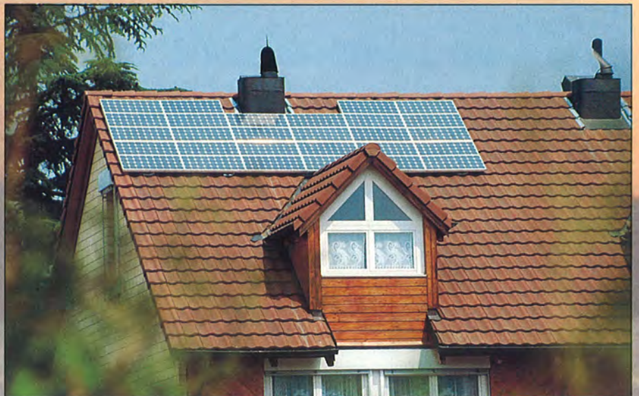
Das hauseigene Kraftwerk: 8 Monate dauerte es von der Planung bis zur Inbetriebnahme.
